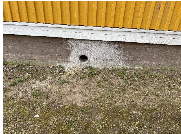
Kuva 7. Jälkikäteen tehty korvausilmaluukku. Ei verkkoa.
