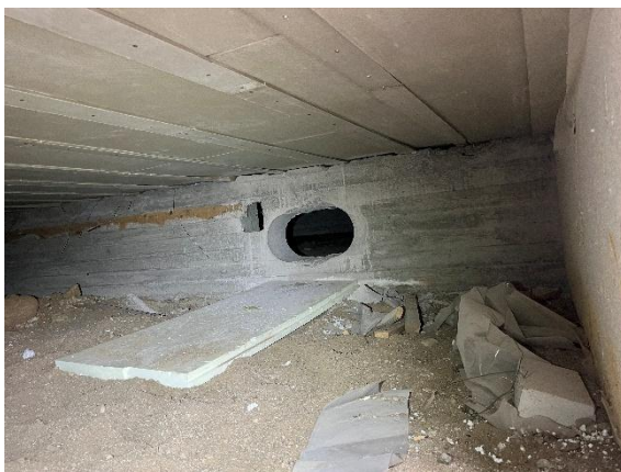
Kuva 8. Alapohjatiilojen välille on tehty kulkureitti. Alapohjatilassa on roskia. Kuva varaston alapohjatilasta.
