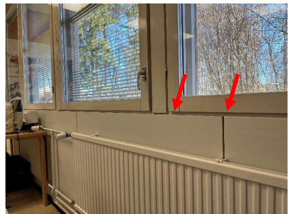
Kuva 37. Epätiivis rakenneliittymä luokkahuoneessa.
