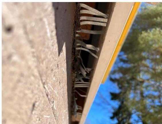
Kuva 36. Puuverhouksen takana on hyvä tuuletusrako. "Hiirilista" on vaurioitunut.
