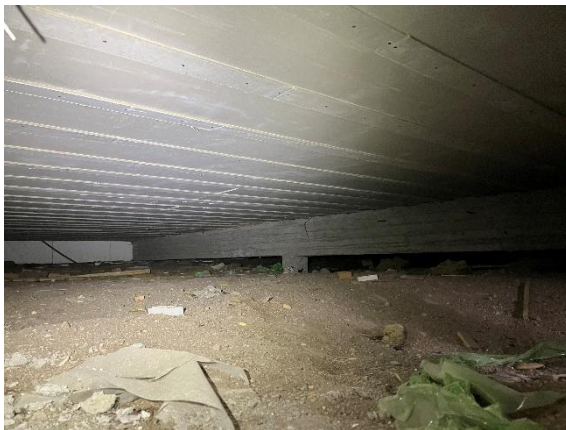
Kuva 12. Yleiskuvaa liikuntasalin alapohjatilasta. Beto-nipalkin ja maanpinnan välinen rako on pieni. Tilassa on rakennusjätettä.
