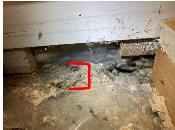
Kuva 25. Höyrynsulku ei ole yhtenäinen.
