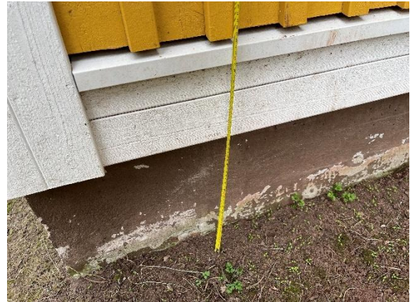
Kuva 5. Sokkelipinnoitteessa on pintavaurioita.
