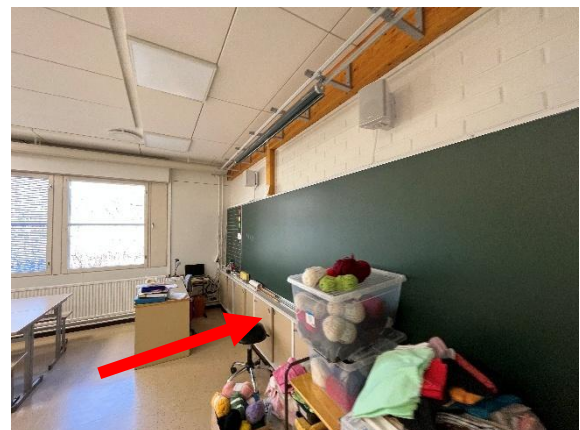
Kuva 53. Havaittu kaasun tulo tilaan.
