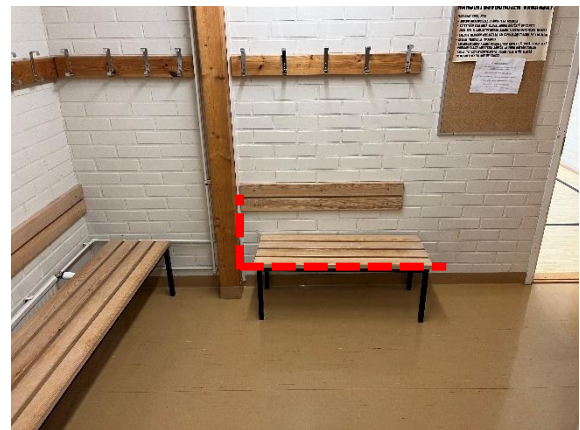
Kuva 51. Havaittu kaasun tulo tilaan.
