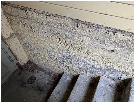
Kuva 8. Portaissa maalipinta hilseilee.
