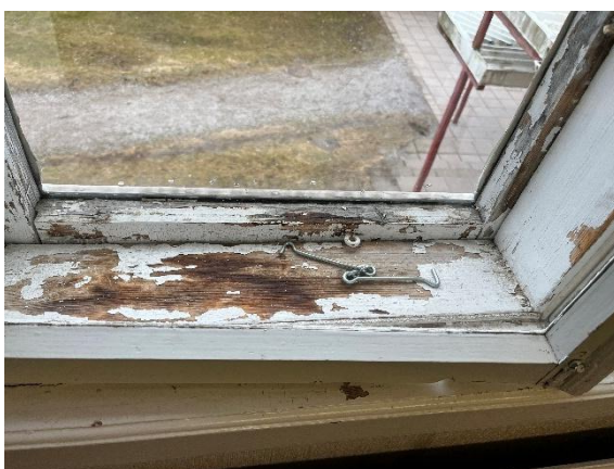
Kuva 22. Toisen kerroksen ikkunoiden maalipinta on heikkokuntoinen ja puu laho.
