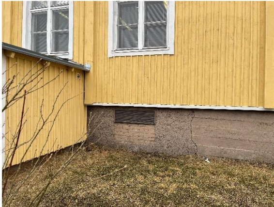
Kuva 6. Sokkelissa paikoin halkeamia.
