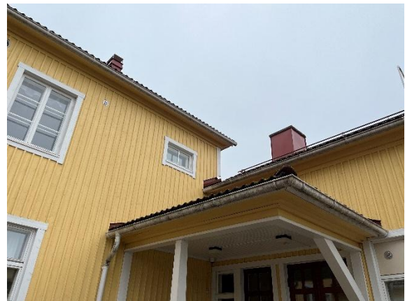
Kuva 61. Vesikourut ovat likaantuneet.
