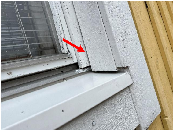
Kuva 18. Ikkunoiden ulkopuolinen vesitiivevyys on kohtalainen. Kuvassa osoitettu nuolella mahdollinen vuoto-piste.
