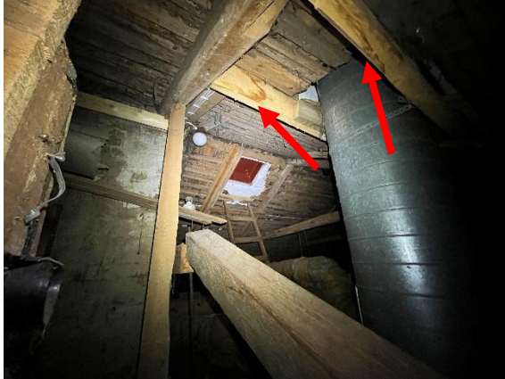
Kuva 64. Kuvassa osoitettu veden aiheuttamia jälkiä.
