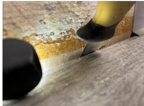
Kuva 28. Rakenneliittymä on epätiivis.
