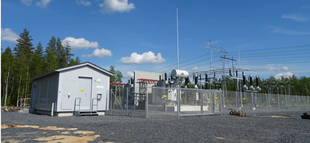
Kuva 10. Esimerkki tuulivoimapuiston sähköasemasta (Oltava, Pyhäjoki).
